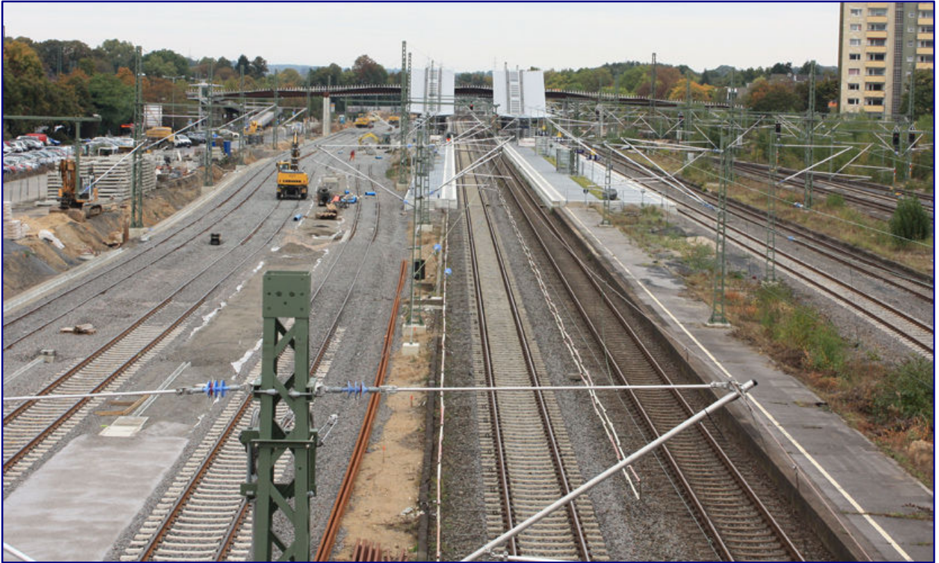
Nach Abriss der alten Bahngelände wird im Jahr 2016 mit Hochdruck an den neuen Gütergleisen gearbeitet. Der neue Bahnhof Opladen – eher ein Haltepunkt – steht bereits.
