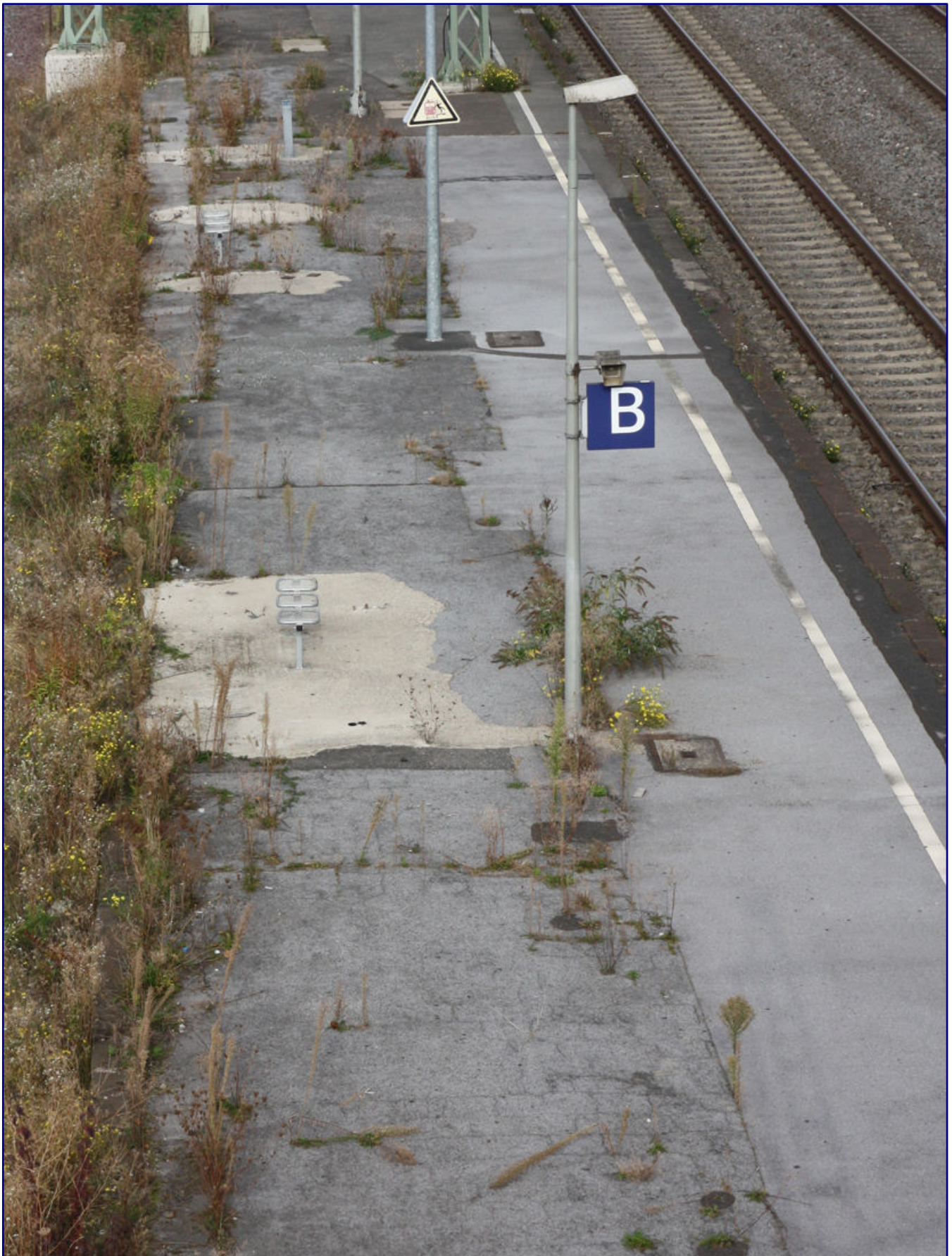
Reste vom alten Bahnsteig 1 sind im Jahr 2022 immer noch vorhanden, leider nicht begehbar.
