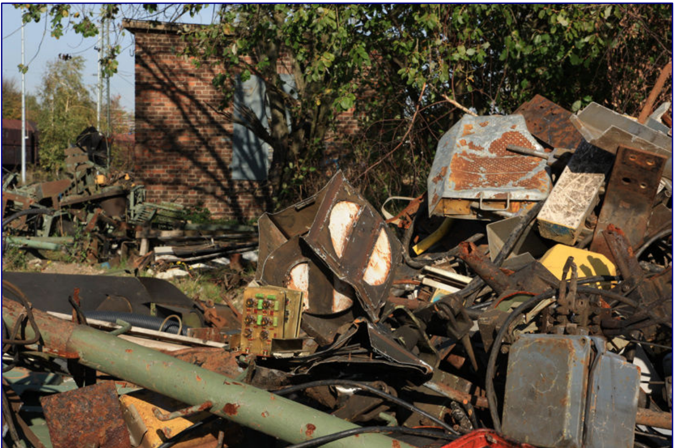
Der Abriss der nördlichen Werkstätten, meist Halle 2 genannt, ist im Jahr 2013 voll im Gange (Bild oben). Der Gleisrückbau und seine typischen Folgen in Folge von Hinterlassenschaften sind hier ebenfalls zu sehen (Bild unten).
