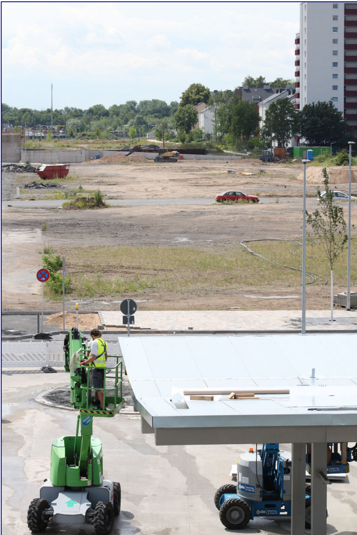
Im Jahr 2020 war von den alten Gütergleisen schon lange nichts mehr zu sehen, im Vordergrund laufen die Arbeiten für den neuen Busbahnhof.
